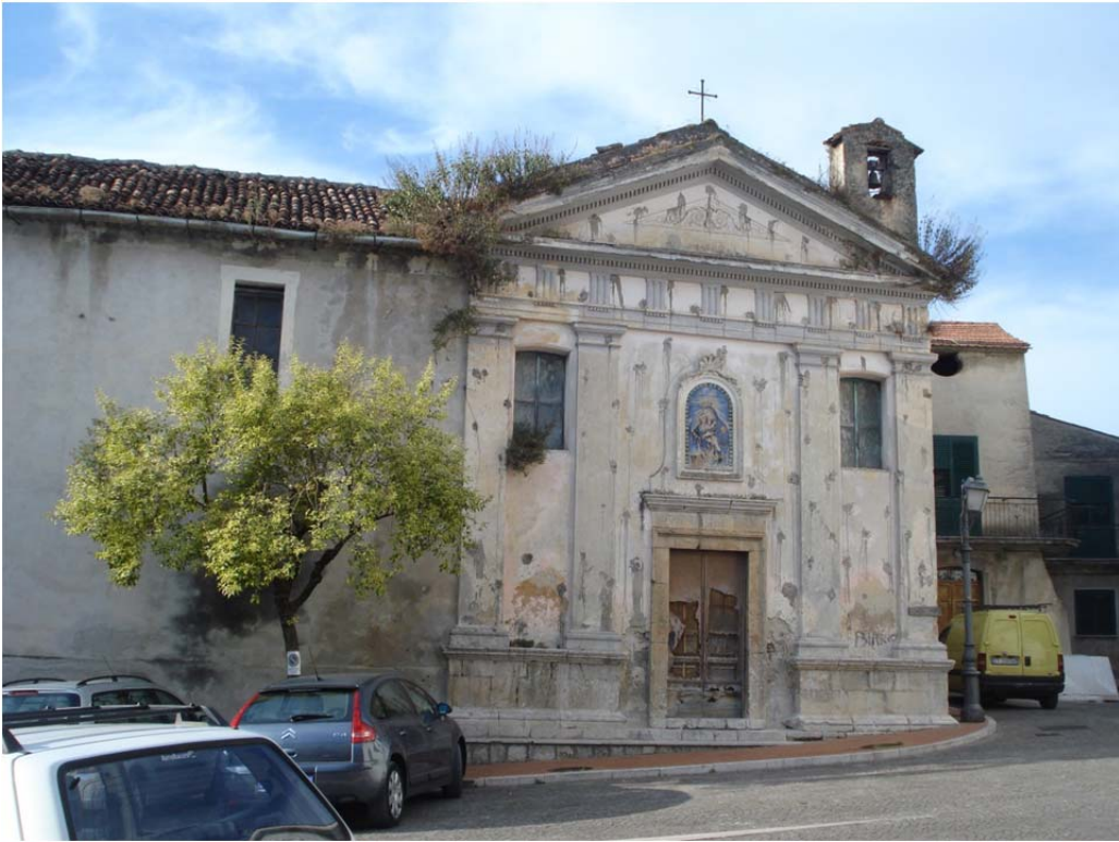
Facciata dell'Oratorio: si notano le perforazioni effettuate nel I Lotto dei Lavori (1989-1992)
