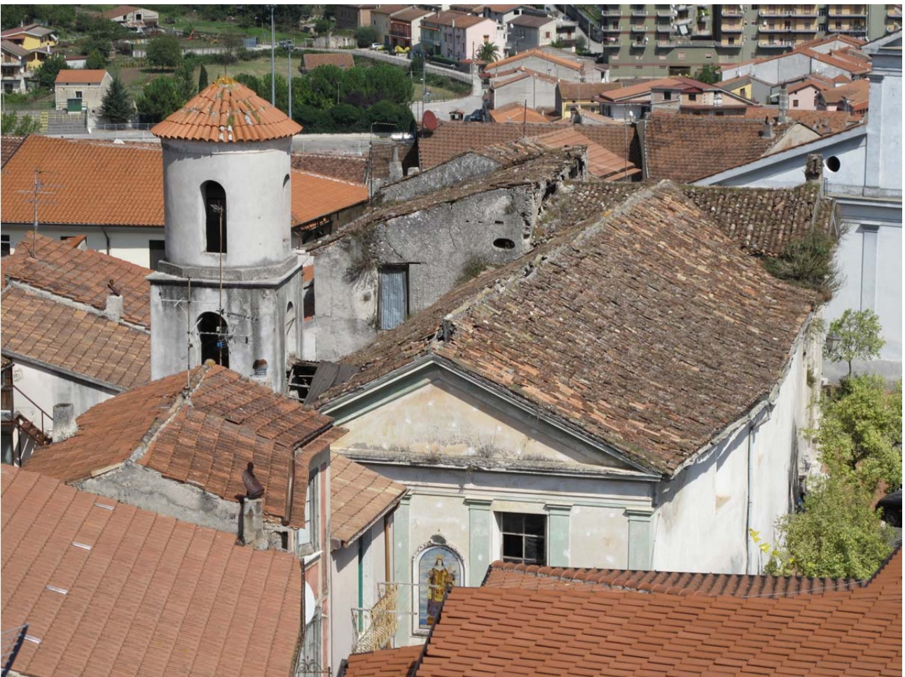
Vista della Chiesa: si nota il campanile oggetto di intervento nel I Lotto (1989-1992)
